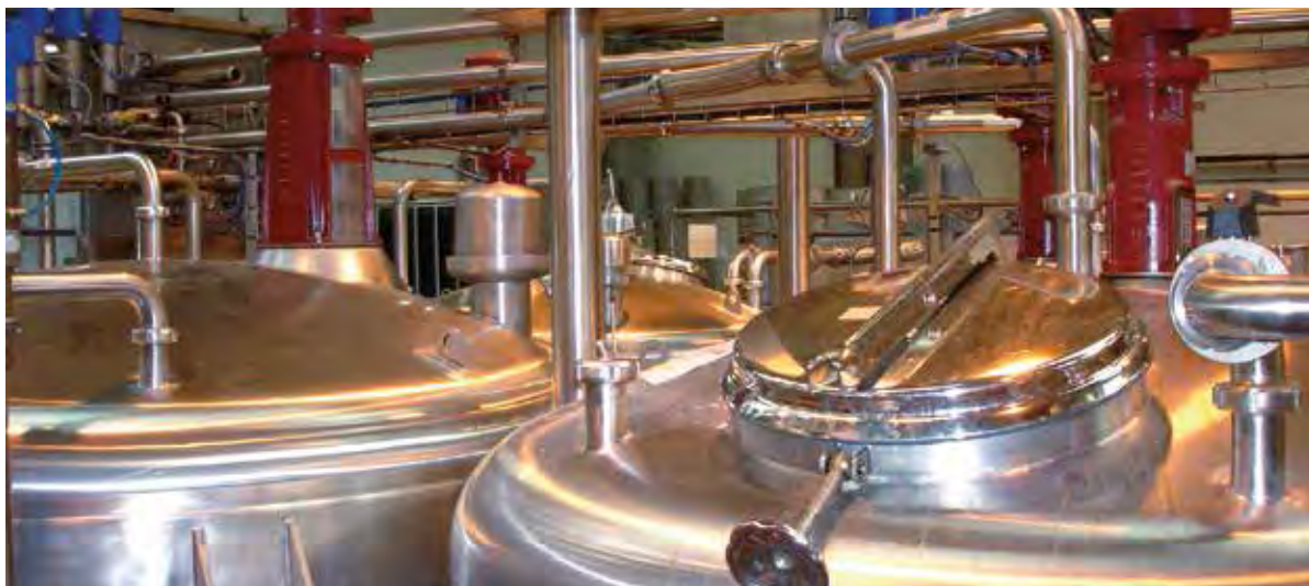
Емкости с многочисленными присоединенными трубопроводами
