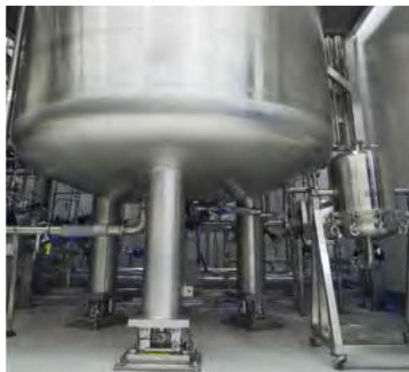
Нижняя часть реактора, установленного на весовых модулях сжатия.
